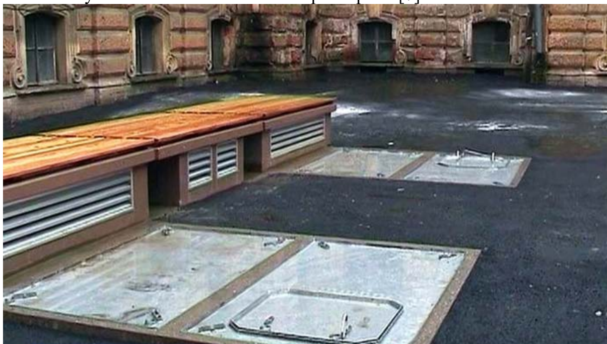
Рисунок 3 – Подземная подстанция в г. Санкт-Петербург
