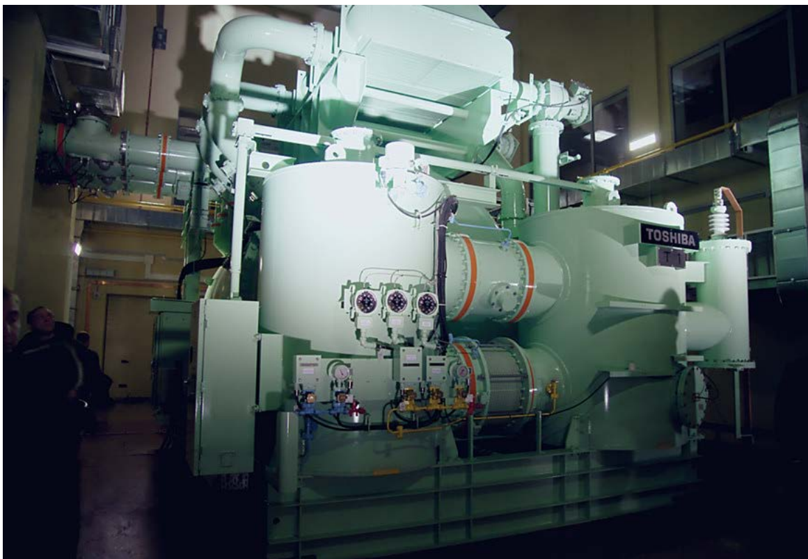
Рисунок 1 – Элегазовый трансформатор 220/20 кВ мощностью по 63 МВА производства Toshiba (Япония)
