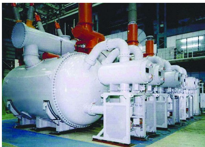
Рисунок 3 – Подстанция с элегазовыми трансформаторами
